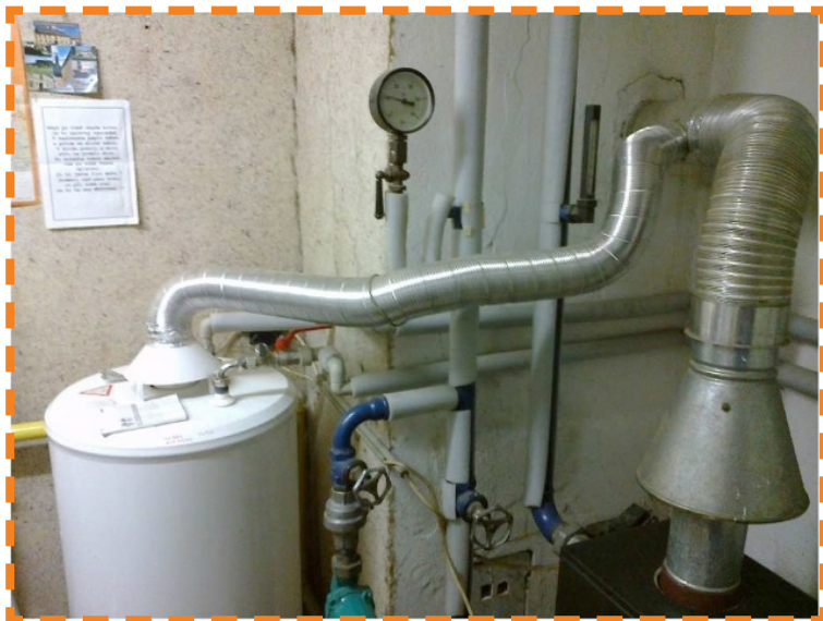
Příklad složitého provedení spalínové cesty a špatně provedeného průchodu spalínové cesty hořlavou konstrukcí.
