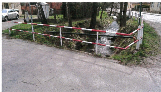
Pravé zábradlí – stejná závada.
