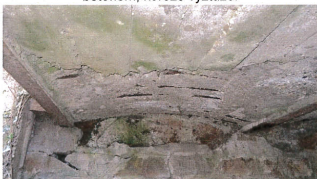
Levé krajní pole desky NK nad OP2 – koroze výztuže.
