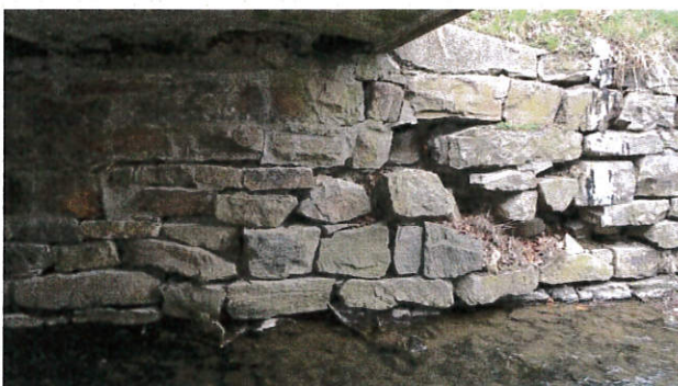
Pohled na levou stranu opěry. Vypadlé kameny vytvořily kavernu.
