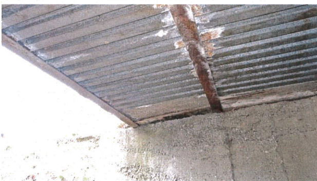
Pravá rozšířená část NK nad OP1 – koroze nosníků a trapézových plechů.
