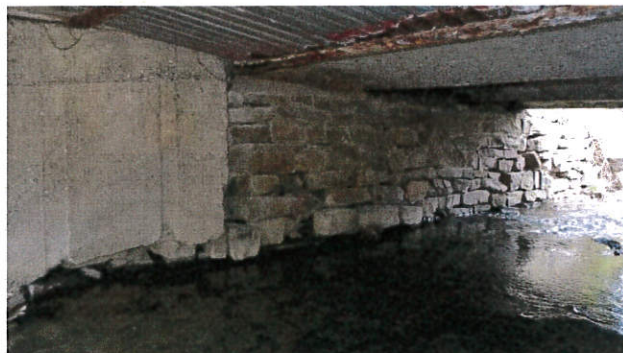
OP1 vlevo rozšíření, vpravo původní kamenná opěra. Rozšíření-obetonování původní opěry je podemleté.
