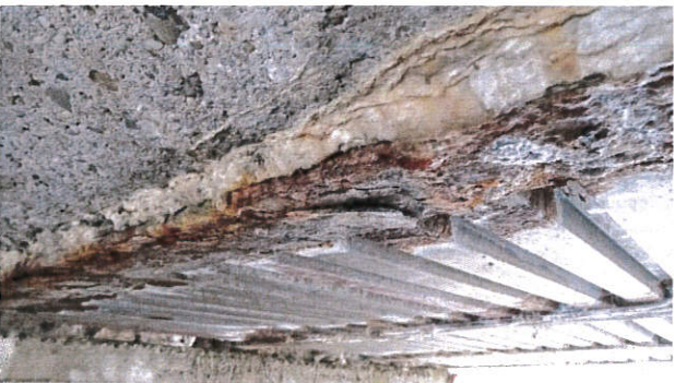
Detail zkorodované spodní pásnice nosníku rozšířené části před OP2.
