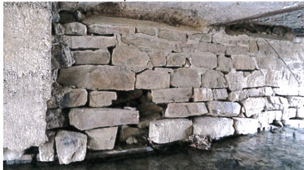
Kameny zdiva v dolní části OP1 jsou rozvolněné a vysunuté do koryta.
