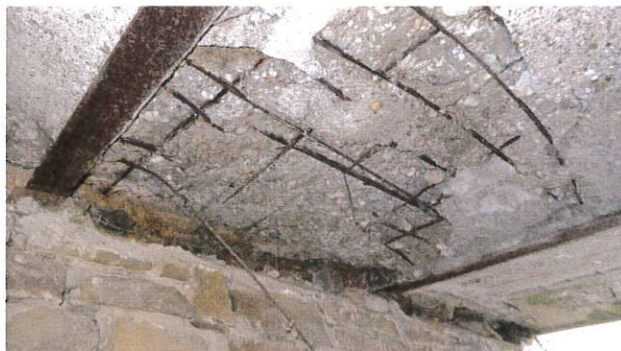
Střední deska NK nad OP1 – zcela rozpadlá nosná betonářská výztuž nad OP1.
