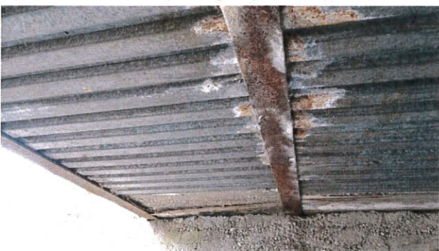
Detail foto výše – nad OP1 chybí trapézový plech.
