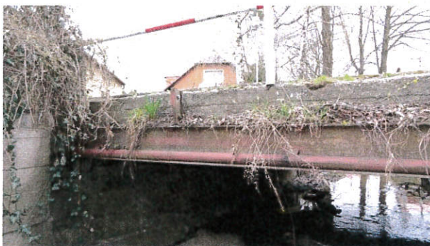
Levý bok NK před OP2. Chybí mostní řimsy.
