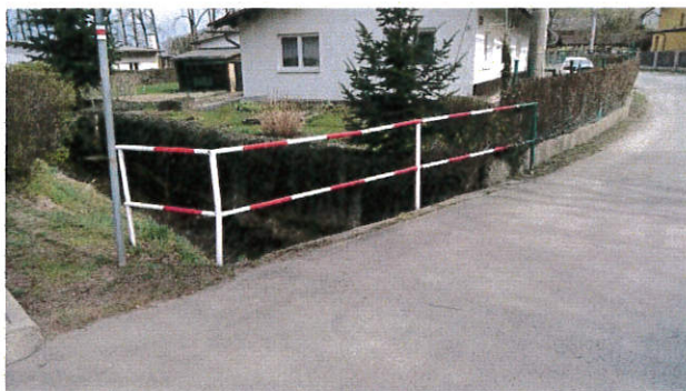
Pohled na levé zábradlí – chybí svislá výplň.
