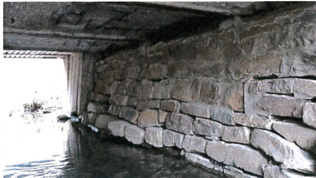
Pohled od výtoku. Po celé délce opěry je rozpadlá spárová malta.
