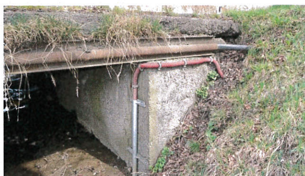
Pravá strana OP2. Není provedeno křídlo.
