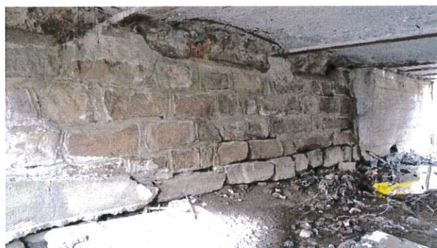
OP2 – rozpadlá spárová malta kamenného zdiva ve spodní části opěry.
