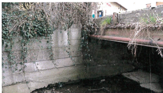
Křídlo K2L – ve spodní části je křídlo podemleté.
