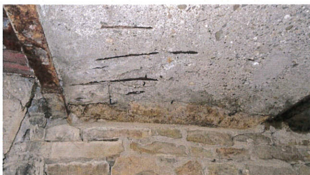
Původní betonová monolitická deska NK mezi nosníky ve tvaru klenbičky. Malé krytí výztuže betonem, koroze výztuže.
