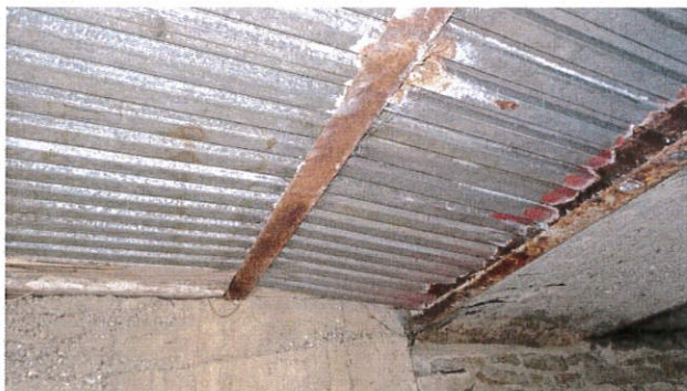
Pravá rozšířená část NK nad OP1 u středu mostu – koroze nosníků a trapézových plechů.
