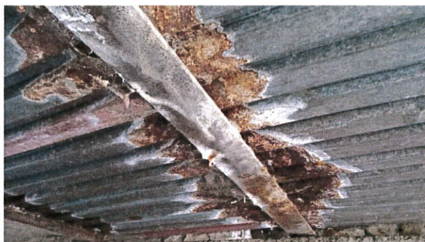
Střední nosník rozšířené části NK před OP2. Zatékání konstrukcí a silná koroze plechů.
