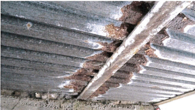
Dtto foto vedle. Koroze trapézových plechů.
