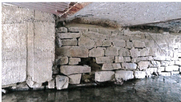
Pravá strana původní kamenné opěry OP1. Rozpad zdiva opěry, kaverna, zcela rozpadlá spárová malta.
