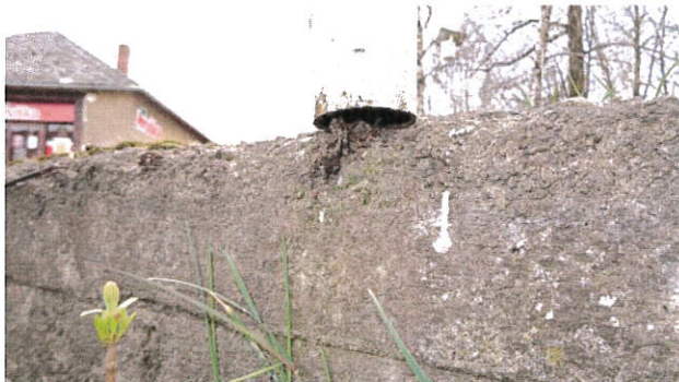
Sloupek levého zábradlí na výtoku je jen opřený o římsu – zábradlí je uvolněné.
