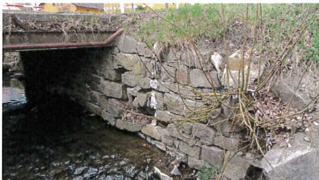
Rozpadlé zdivo křídla K1L.
